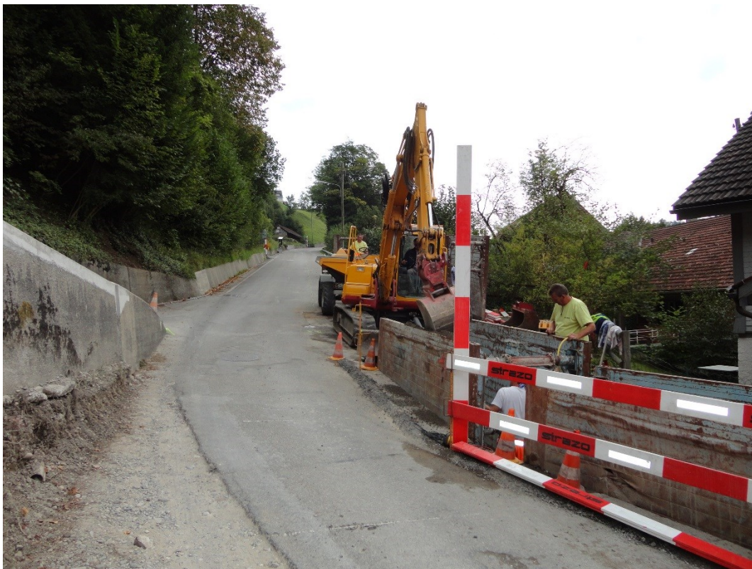
Enge Platzverhältnisse; Foto vom 11.09.2012
