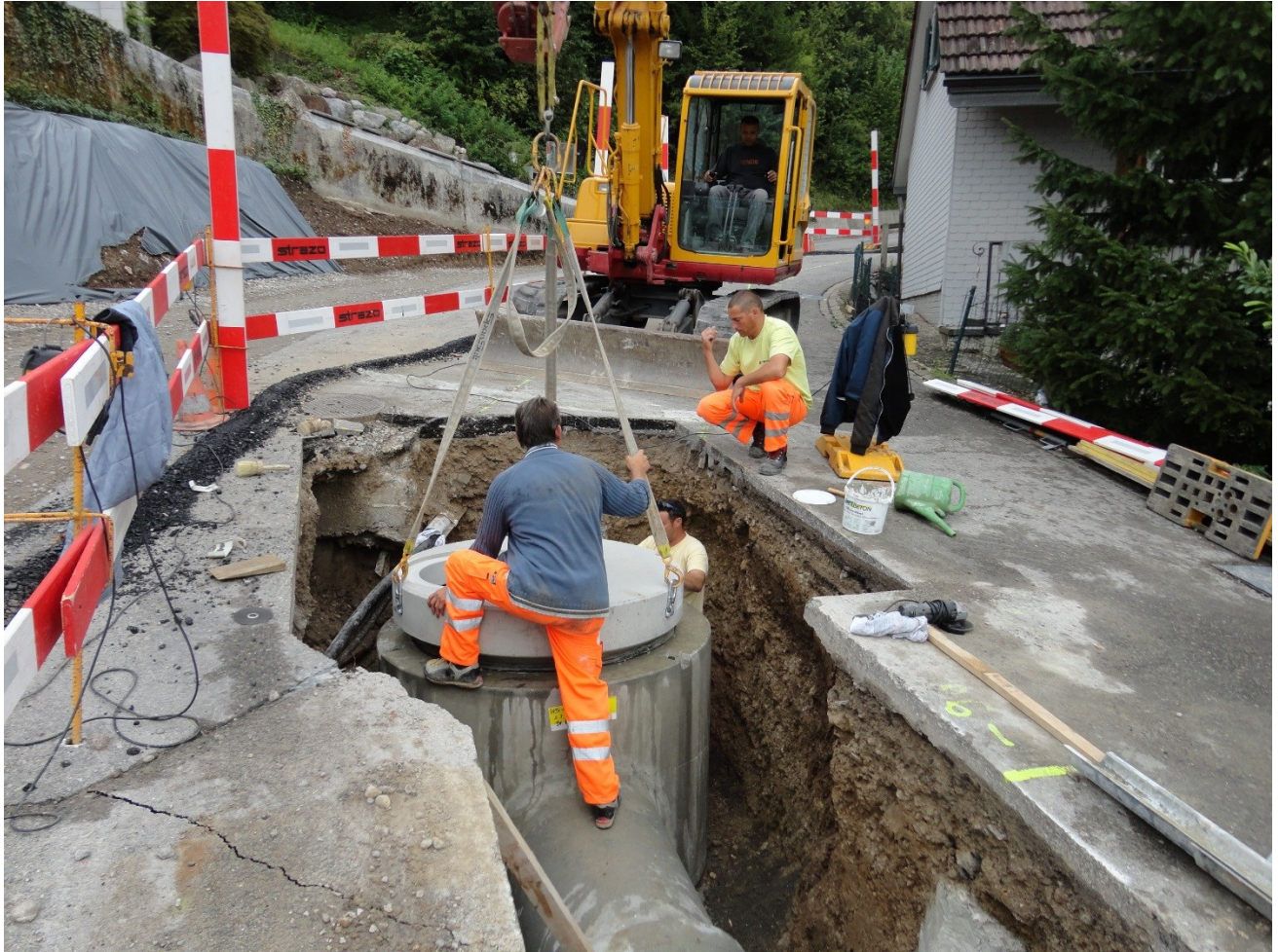
Enge Platzverhältnisse; Foto vom 04.09.2012
