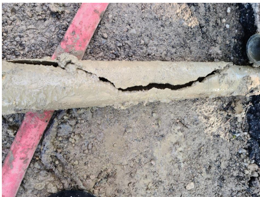
Bild links: Wasserleitungsdefekt an einer Faserzement- leitung. (Versorgungsleitung Wolfenzädel)
