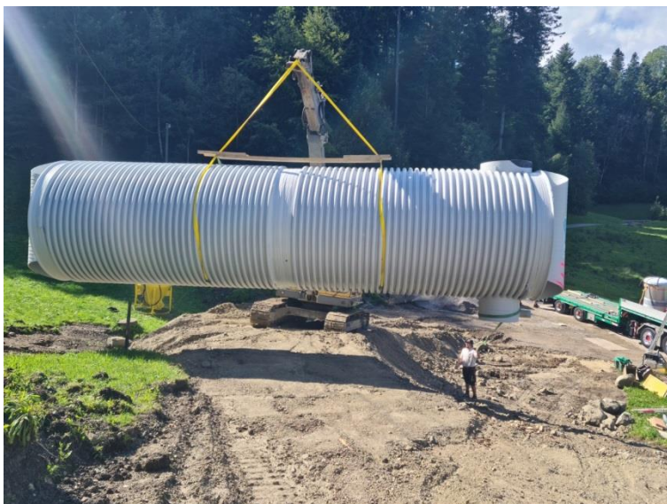
Bild links; Löschbehälter 50 m 3
