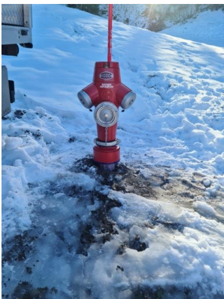
Bild links; Hydrant, durch Löschbehälter gespeisen
