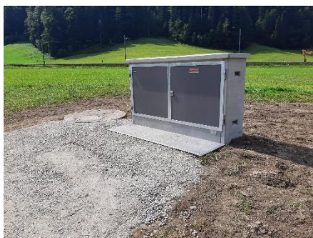
Elektrokabine mit Pumpenschacht links
