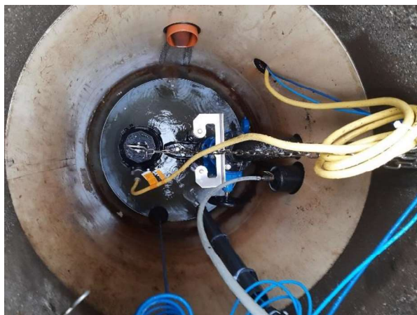
Abbildung 26: Blick in den Pumpenschacht mit der neuen Ausrüstung
