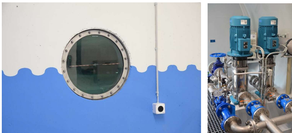
Abbildung 17: links Fenster zur Wasserkammer im Reservoir Brandholz, rechts Einblick ins Stufenspumpwerk Hörnen
