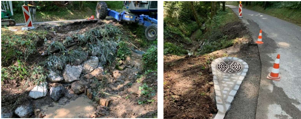
Abbildung 4: links Erdrutsch, rechts verbesserte Strassenentwässerung
