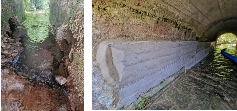
Abbildung 10: links ausgebrochene Sohle, rechts reprovilierte Sohle und Seitenwände
